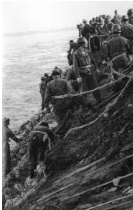
▲水梨町地内の信濃川堤防損壊（6月）
