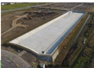
雨水調整池(長岡北スマート流通産業団地)
