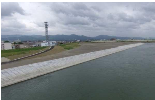
図 2-3-5-9 《信濃川流域の治水安全度を高める 信濃地区築堤護岸の改修》
