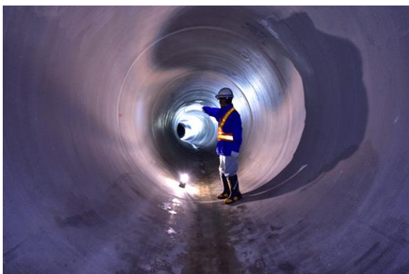
図 2-3-5-11 ≪表町貯留施設≫
