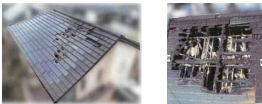
写真 1 屋根の被災状況（右はモジュール撤去後）
