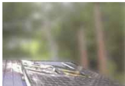
写真 2 屋根の被災状況
