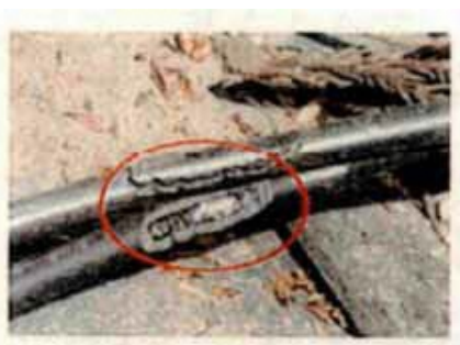
写真 3 小動物が噛んだと思われる ケーブルの損傷箇所
