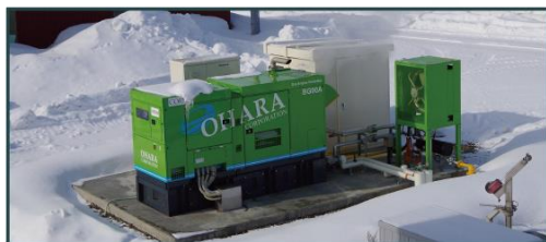
バイオガス発電機
