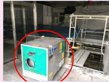
集塵機を設置し室内の換気を実施
