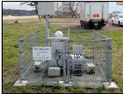
緊急時モニタリングポスト【126局】 (バッテリー付)
