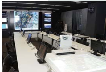
最新システムを備えたアオーレ長岡の災害対策本部会議室
