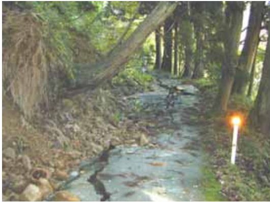
（県道崩落箇所）
