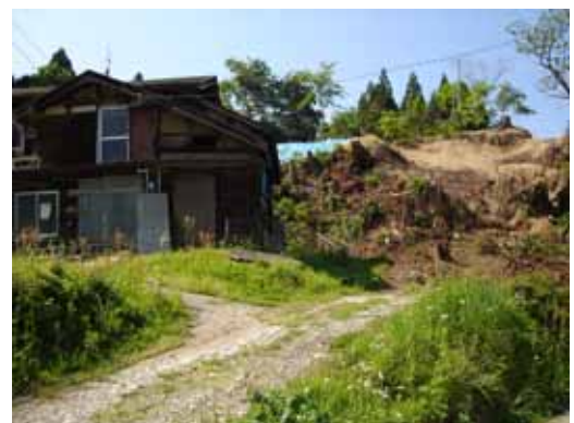
（がけ崩れによる危険住宅）
