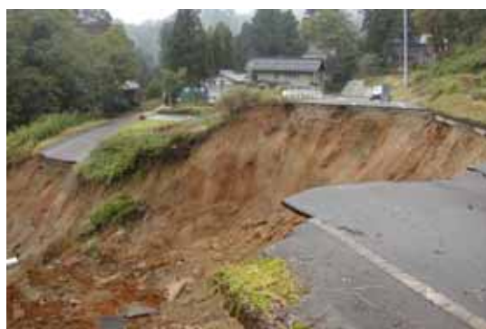
（県道崩落箇所）
