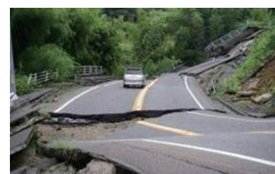
新潟県中越沖地震(長岡市大積 国道8号) 出典:「平成19年7月16日 新潟県中越沖地震」北陸地方整備局 北陸技術事務所
