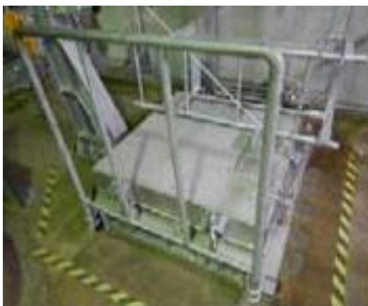
<取水槽閉止板>
