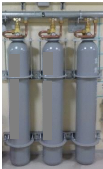
消火薬剤貯蔵容器 (ハロゲン化物ポンペ)
