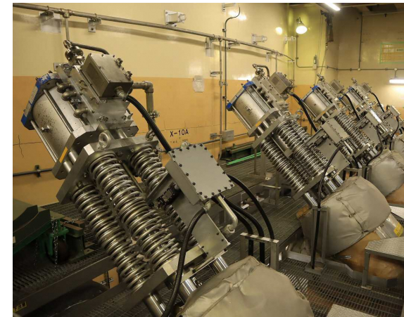
確認する弁の例 主蒸気隔離弁
