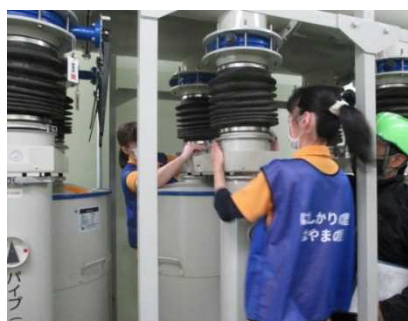
陽圧化装置の起動準備
