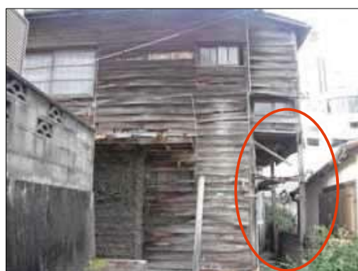
柱の数箇所に破損がある例
