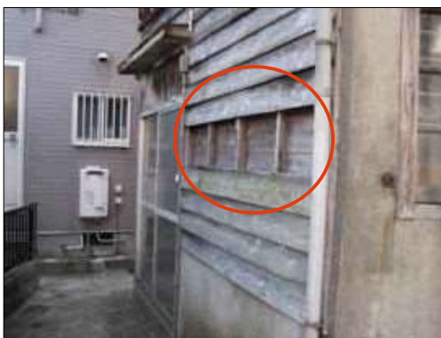
外壁の仕上材の一部がはがれ、 下地が露出している例
