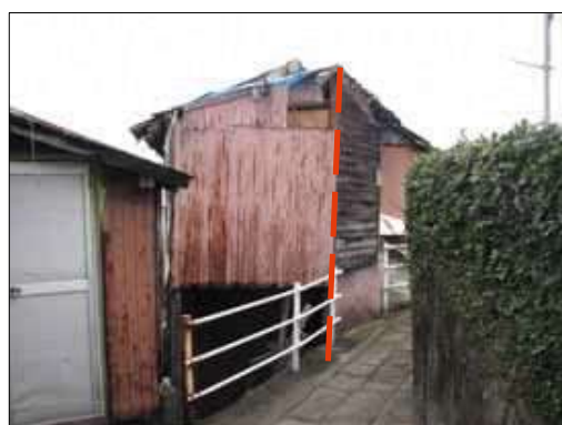
一部の柱が傾斜している例
